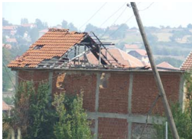
Разрушене српске куће у Руднику
